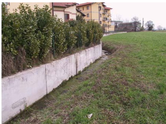
Foto 3: Accumulo d'acqua nel tratto settentrionale del Colatore Vistarina.
